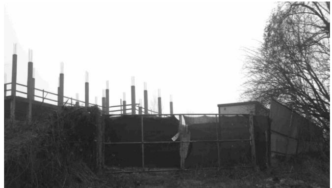
cantiere abbandonato – febbraio 2014
